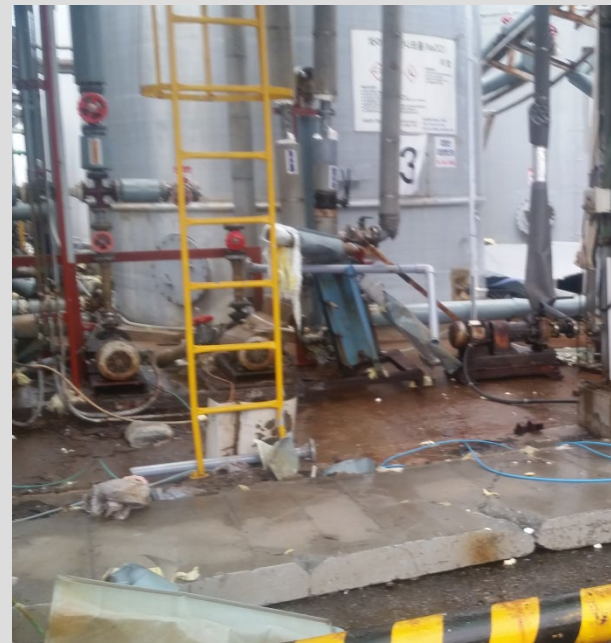
방유제 콘크리트 벽체가 무너져 버림
